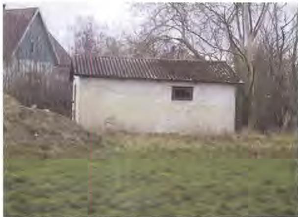
Alla hade inte frys hemma: Kattarps andelsfrys från 1959. Byggnaden är tyvärr i dåligt skick (Kattarp 27:1).
