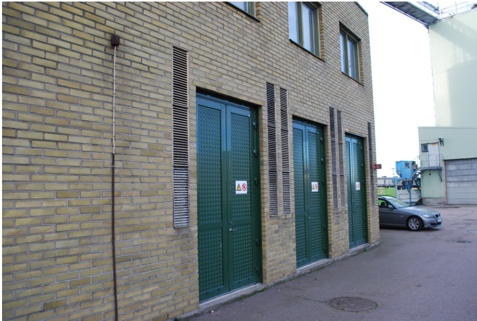
Figur 38 Bild på ventilationsutblås i fasad (foto: Erik Hedman)
