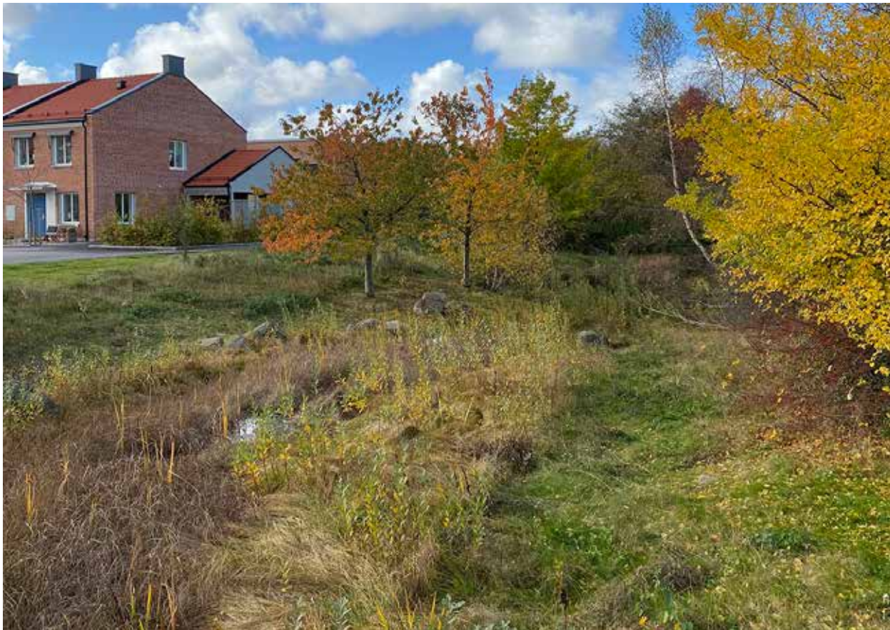
85. Foto Naturstråket söder om samfälligheten Dagvattnet. I bakgrunden syns Grönfinksgatan. Dammanläggningen är igenvuxen och buskagen runt omkring behöver gallras. Stora stenar är utspridda längs dammslänterna vilket försvårar skötseln.
