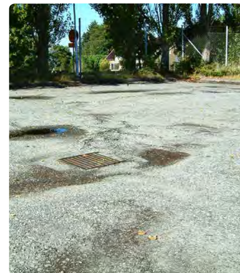
Det blir ofta sättningar runt rännstensbrunnar.
