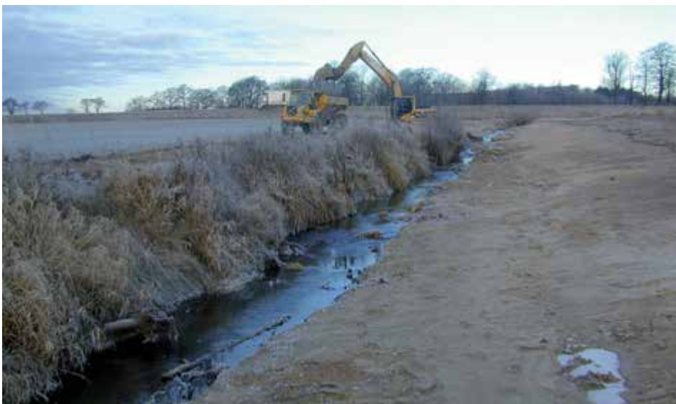
Lussebäcken under omgrävning, östra sidan har flackats ut och arbete pågår längs den västra.
