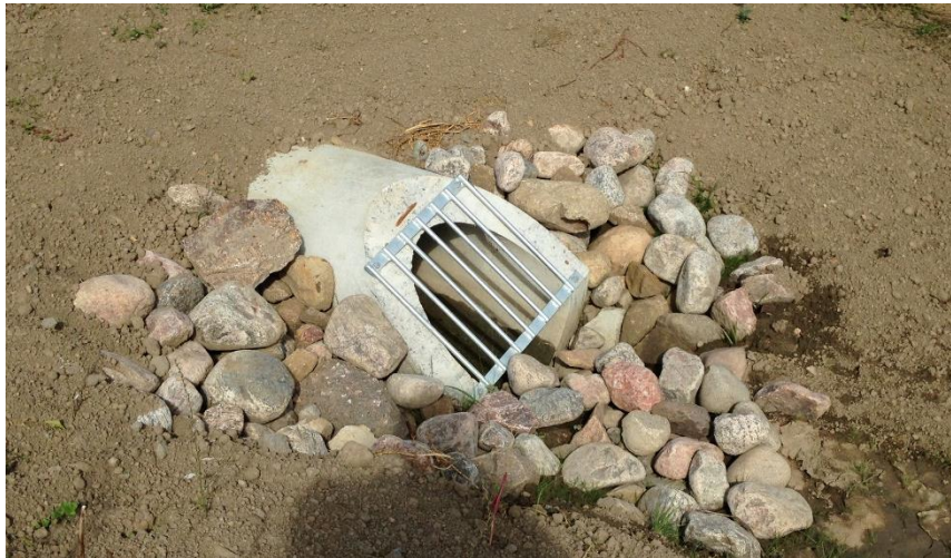
Figur 7. Tvåtredjedelsgaller och trumögats form anpassat till släntlutning vilket är ett krav vid inlopp till dagvattendiken och dammar.
